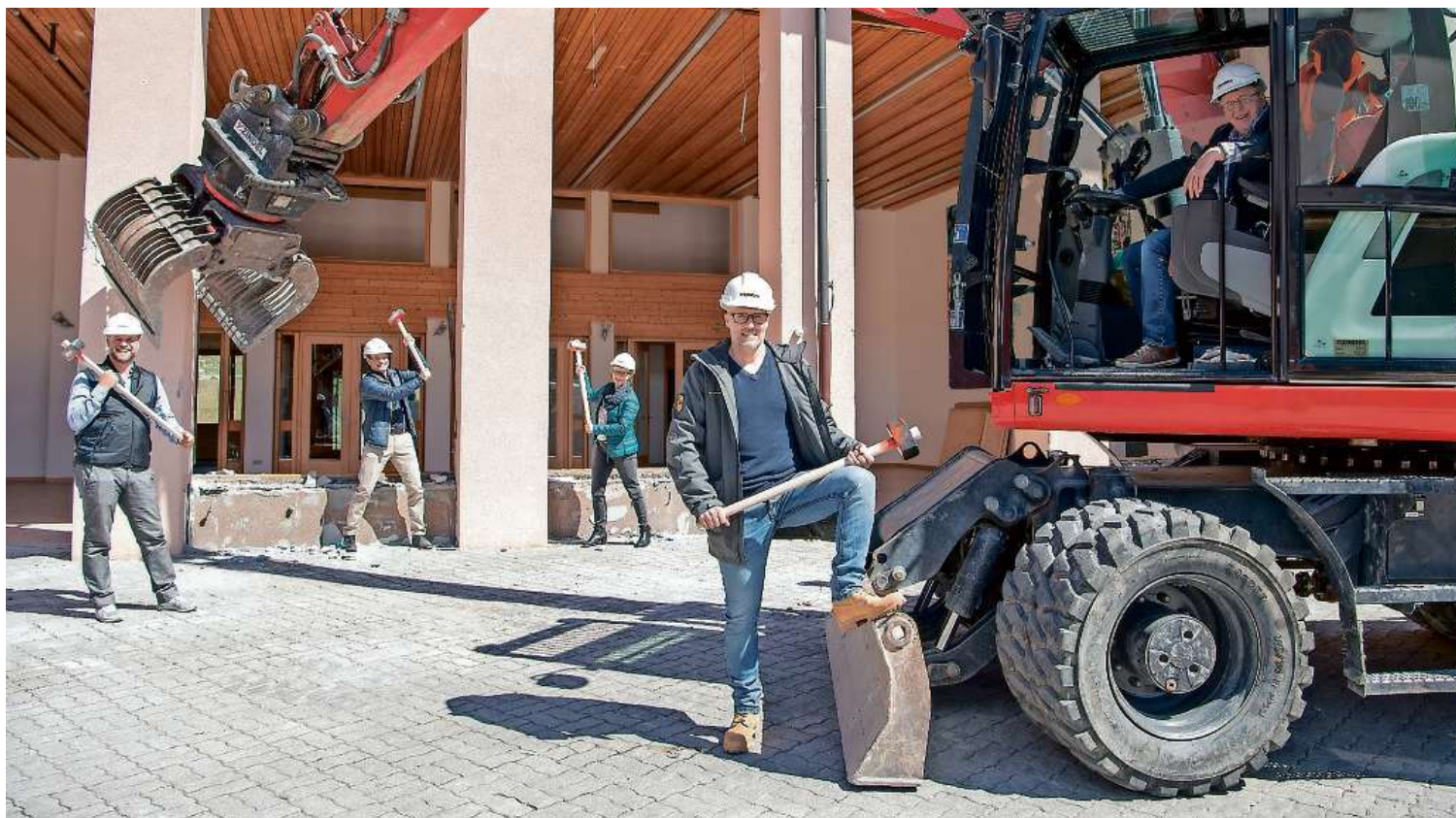
Mit vereinten Kräften rücken sie dem alten Zwischentrakt der Schule Lenzerheide zu Leibe: Schulleiter Stefan Langenegger, Architekt Joos Gredig, Elisabeth Sigron, Departementsverantwortliche Bildung und Kultur der Gemeinde Vaz/Obervaz und Präsidentin der Baukommission Schulanlage Lenzerheide, Andreas Ledermann, stv. Leiter Bau Gemeinde Vaz/Obervaz und Gemeindepräsident Aron Moser. Bilder Nicole Trucksess
